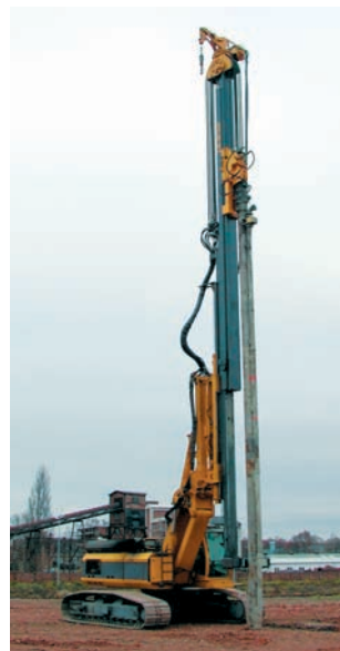
RG 18T mit Tiefenrüttler TR 17 (Rüttelortbetonsäulen), Leipzig RG 18T with deep vibrator TR 17 (vibrated concrete columns), Leipzig, Germany
