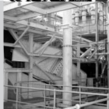
MCP, Modulare Kohlenwaschanlage
