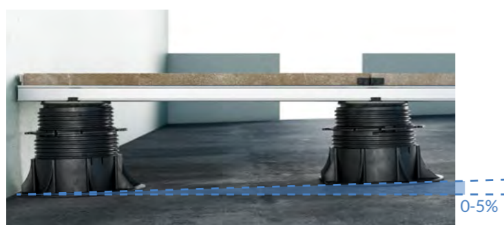
Dettaglio compensazione pendenza con utilizzo di sistema travetto per posa di piastre ceramiche.
